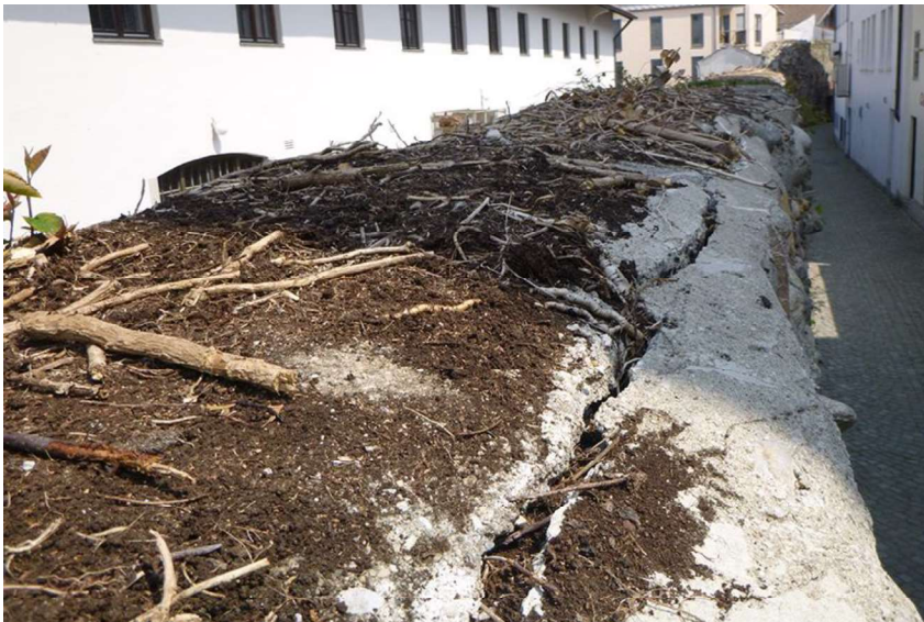
Zementkappe, darunterliegend Durchwurzlung und lose Steine
