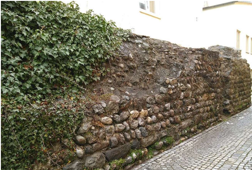
Bewuchs, darunterliegend zerrüttetes Mauerwerk
