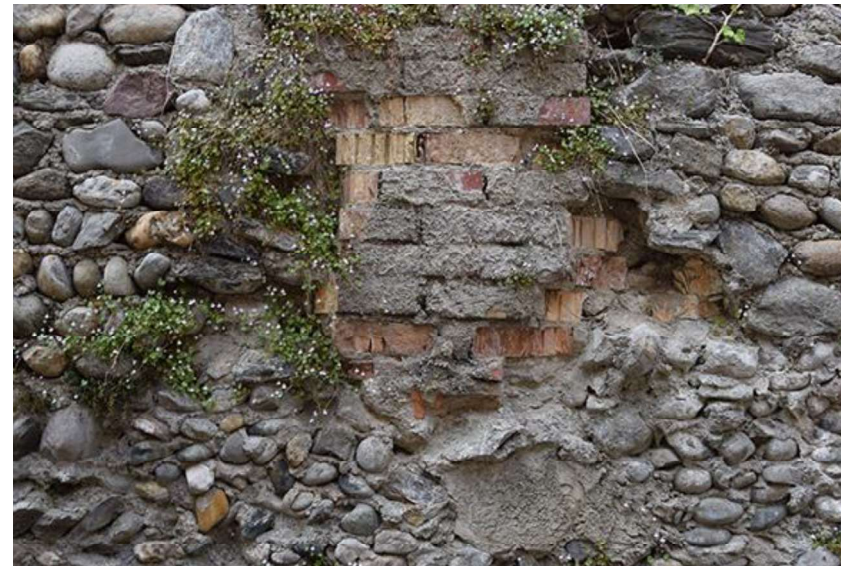
Rezente Flickungen mit Ziegeln und Zementmörtel
