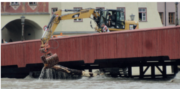
Die Innbrücke musste zeitweise gesperrt werden. Auf der Brücke war ein Bagger im Einsatz, um eine Verklauung von Treibgut zu verhindern. Verkeilen sich mehrere Bäume, ist das Bauwerk durch den entstehenden immensen Wasserdruck in Gefahr.
