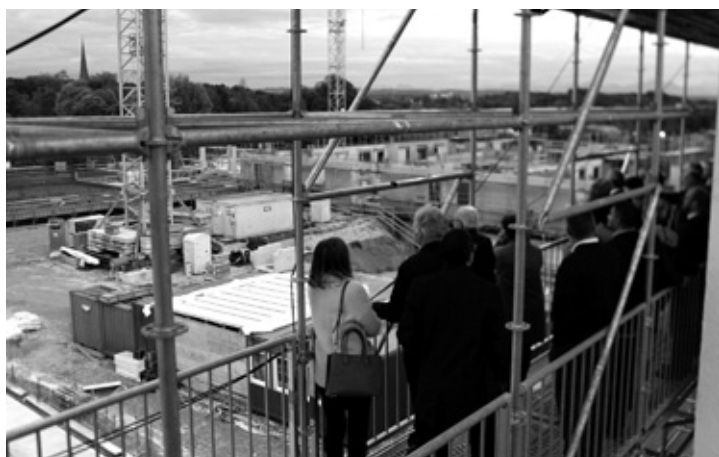
Der Wasserburger Unternehmerstammtisch besichtigte die Großbaustelle von kbo-Inn-Salzach-Klinikum und RoMed Klinik Wasserburg
